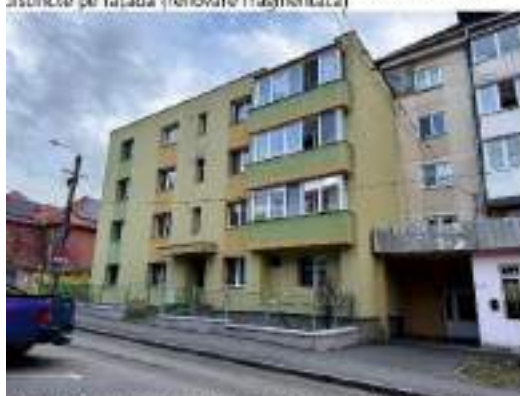
AȘA NU - Placarea acoperirii zonei de acces cu tablă cutată ucioasă; utilizarea vopșilor necorespunzătoare AȘA DA - Închiderea balcoanelor în mod unitar
