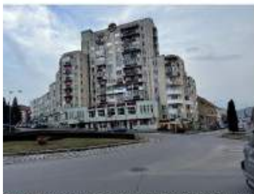
AȘA NU - Fațada degradată cu balcoane închise în mod neuniform Parter și etaj 1 tratate în mod distinct; Prezența vopșilor distincte pe fațadă (renovare fragmentată)
